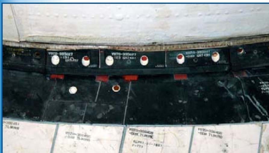
Поврежденная панель теплозащиты на гондole левого двигателя OMS
